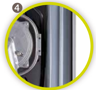
Vaso espansione riscaldamento
