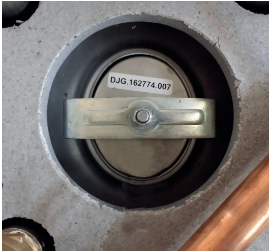
Fig.18 Couverture de maintenance du ballon
