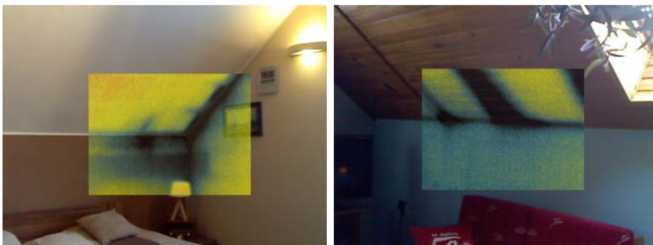
Rysunek 22. Straty ciepła na styku krokiew–termoizolacja oraz na styku termoizolacji ukośnej dachu z pionową ścian (źródło własne)
