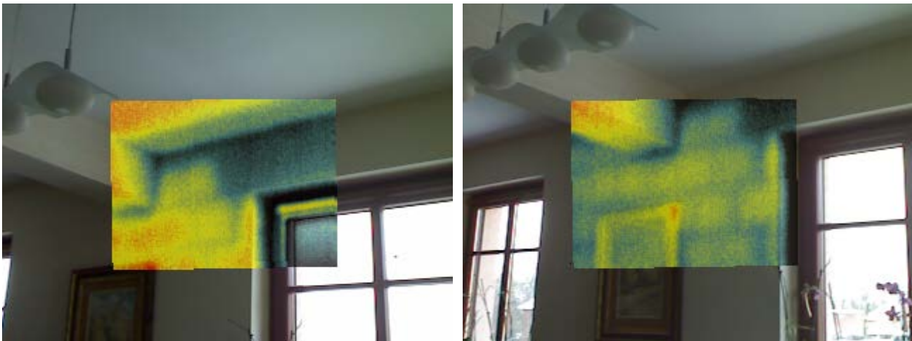
Rysunek 16. Mostki cieplne (termiczne) w okolicach nadproży i w lokalizacjach spoin wspornych i pionowych – widok od środka pomieszczeń (źródło własne)
