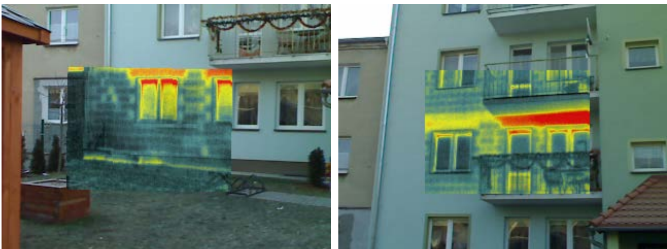
Rysunek 17. Mostki cieplne w okolicach nadproży, oparcie – utwierdzenia konstrukcji balkonów wspornikowych oraz w lokalizacjach spoin wspornych i pionowych murów – widok z zewnątrz (źródło własne)
