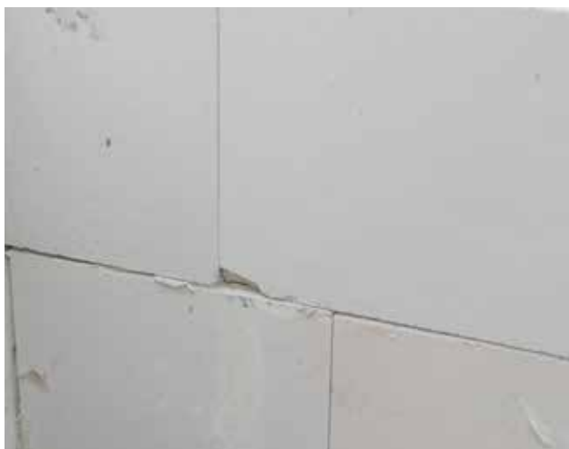
Fotografia 57. Ubytek w murze wymagający uzupełnienia.
