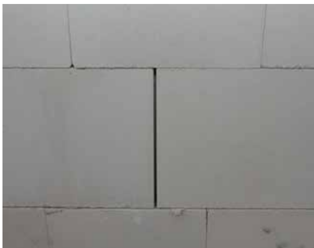
Fotografia 51. Zbyt szeroka szczelina powstała w miejscu połączenia elementów profilowanych, wymagająca wypełnienia zaprawą.
