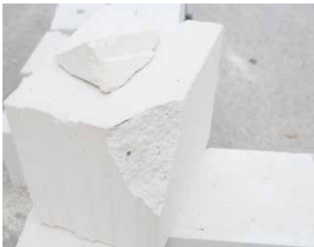
Fotografia 59. Duży ubytek narożnika błočka, który można naprawić.
