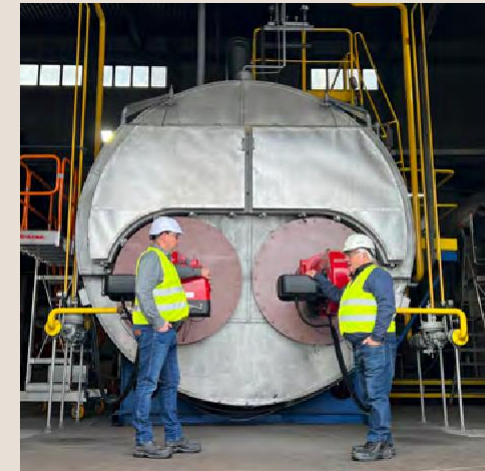
Przemysław Sztąboroski i Marian Misztela sprawdzają kocioł parowy, który został przerobiony z węglowego na gaz ziemny przez żółte rury.
