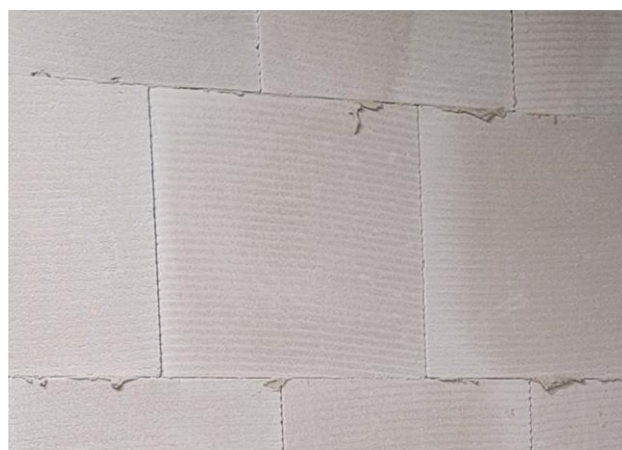
Fot. 7. Panele w kolejnych warstwach powinny zachodzić na siebie nie mniej niż 100 mm.
