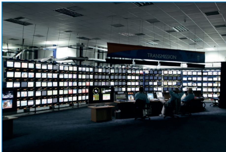
La salle des transmissions du Centre International de Radio et de Télévision.
