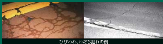
ひびわれ、わだち掘れの例
