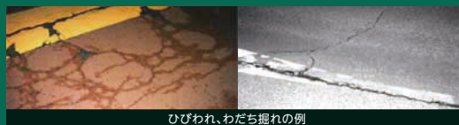
ひびわれ、わだち掘れの例
