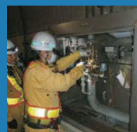
水噴霧装置点検
