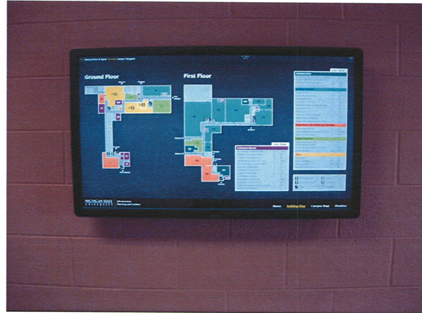
New fire alarm annunciator
