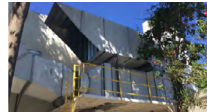
Uniluwa - Kompaktes Klimagerät mit TexFog
