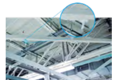
Staubablagerungen an der Decke
