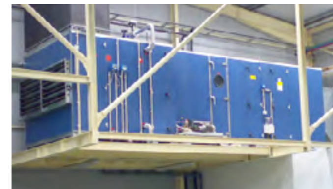
Uniluwa - Kompaktes Klimagerät mit TexFog
