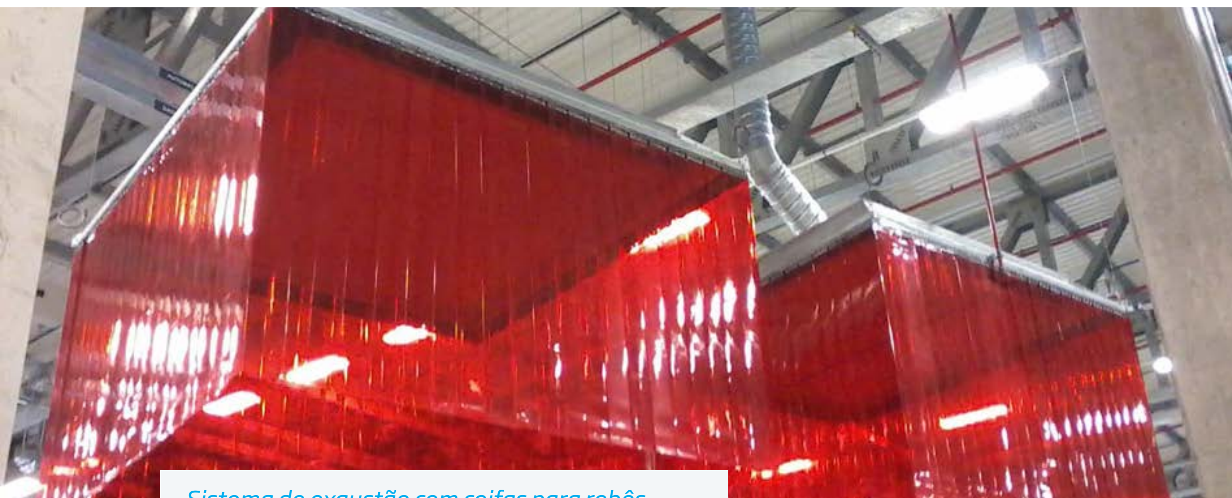
Sistema de exaustão com coifas para robôs
