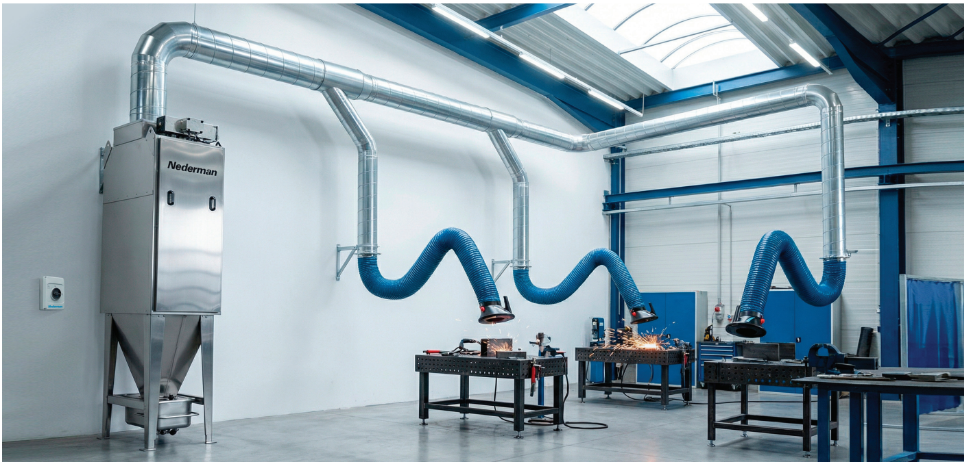
Instalação típica do filtro MCP com vários pontos de captação com braços extratores, tubulação de interligação e ventilador integrado.
