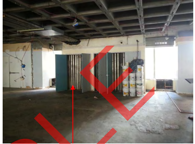
A.29: Conduit Enclosure
