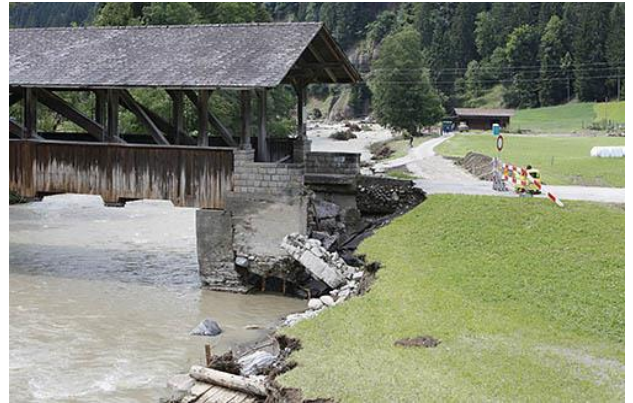
Beschädigte Holzbrücke und Ufererosion an der Emme im oberen Emmental (Foto: Zurich)
