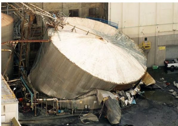
Figura 1 - Ruptura de um tanque de licor branco
