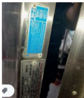
Selo e plaqueta instalado em uma porta corta fogo.
