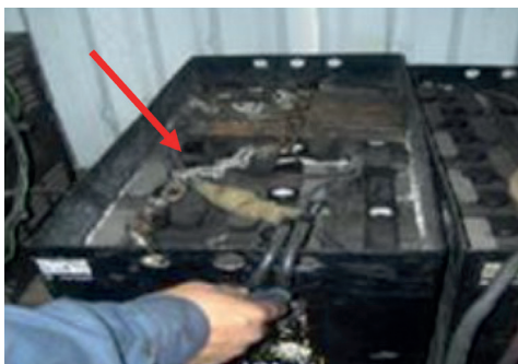
Bateria com corrente deixada próximo aos polos
