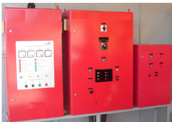
Exemplo dos painéis de controle
